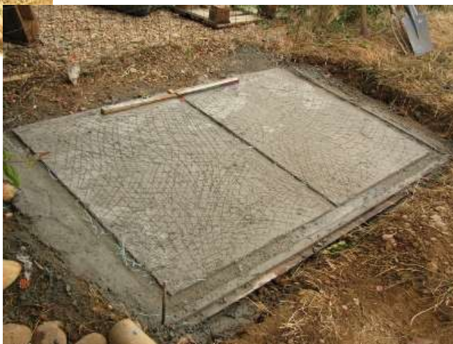
Dalle en pente avec rigoles d'évacuation des liquides en excès
