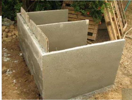
Coulage sans aucun ferrailage grace au mélange sable – ciment – fibre de ficelles de bottes puis démoulage.
